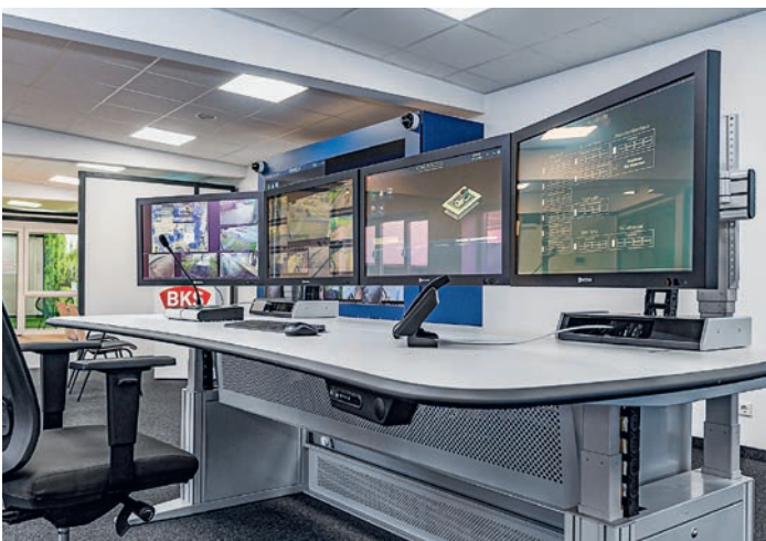
Mit dem Managementsystem Gemos können Sicherheitssysteme überwacht und gesteuert werden.
