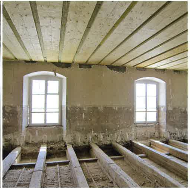
Unten alt, oben neu: Hier ist oben die neue Decke aus Hohlkastenelementen zu sehen.
