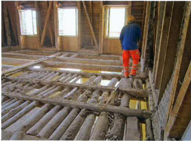
Hier sind noch die alten Deckenbalken, die alle ausgewechselt wurden, zu sehen.
